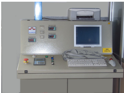
Quadro elettrico della prima macchina installata.
